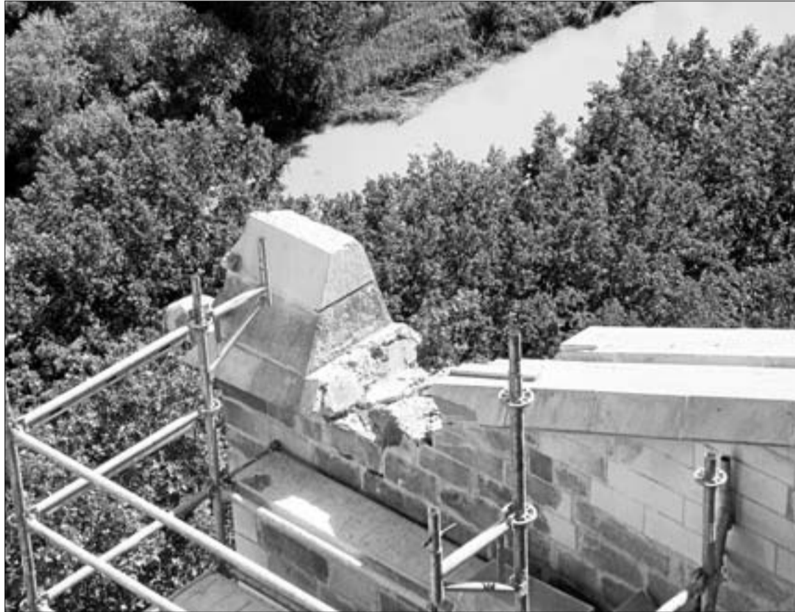
Aspecte del contrafort amb els desperfectes ocasionats pel llamp que hi va caure el mes passat
